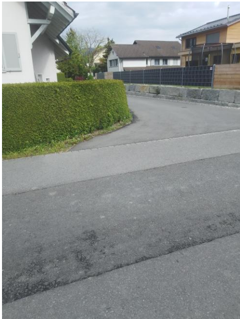
Abbildung 7: Bsp. Einmündung Trattstrasse: Vortrittsregelung nicht klar (es gilt Rechtsvortritt), Sichtzone nicht eingehalten
